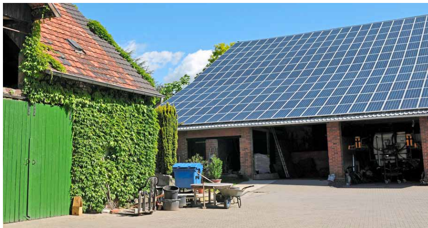
Eine Photovoltaikanlage sollte frei von Staub und Schmutz sein, um die Erträge zu sichern.
