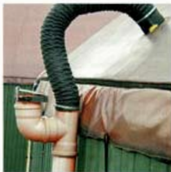
Lecks am Folienrand oder im Abluftstutzen der Tragluftdächer sind keine Seltenheit.
