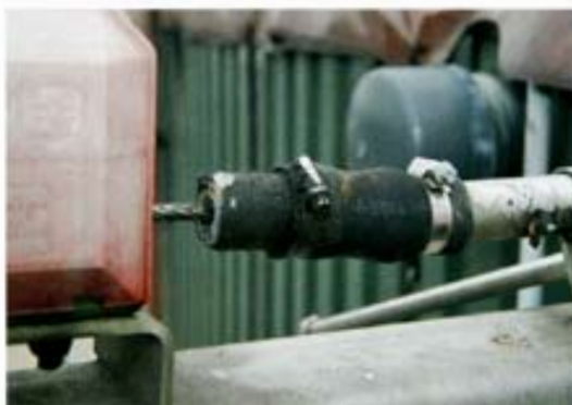
Drahtseil zur Höhenverstellung von Rührwerken im Fermenter: Regelmäßiges Fetten verhindert, dass Gas austritt.
