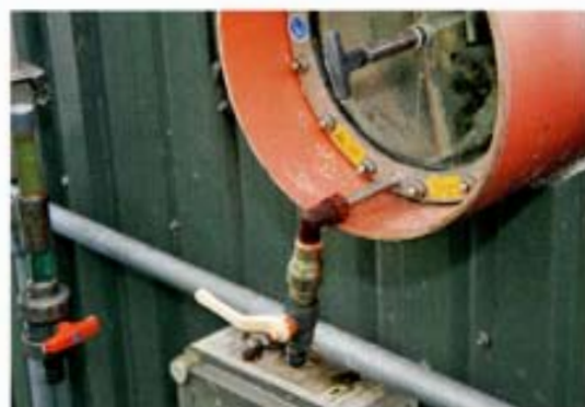
Auch undichte Rohrverbindungen oder verschlissene Gummidichtungen bei Bullaugen führen zu Methan-Emissionen.
